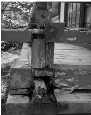
写真5 宮津弁天宮 囲いの腐食
